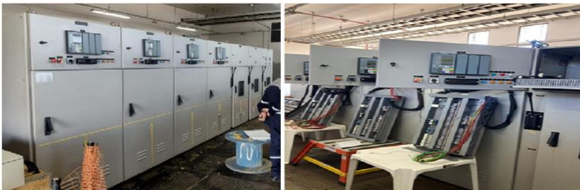
Painéis de Energia
