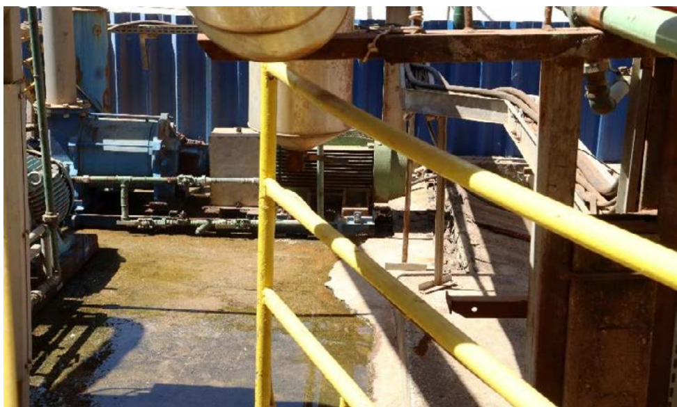
Figura 56. Vazamento de efluentes sobre o piso da planta de tratamento de efluentes.
