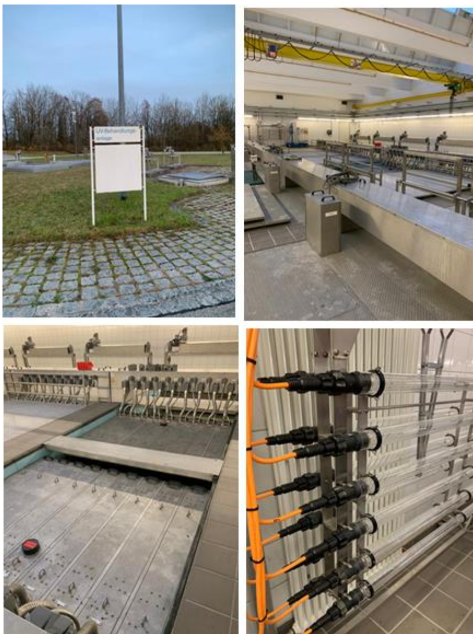
Figura 80. Sistema de desinfecção por radiação ultravioleta (UV) da Estação de Tratamento de Esgoto de Munique.
