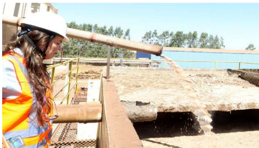
Figura 51. Tanque de equalização, local que recebe todos os efluentes gerados no abatedouro de aves.
