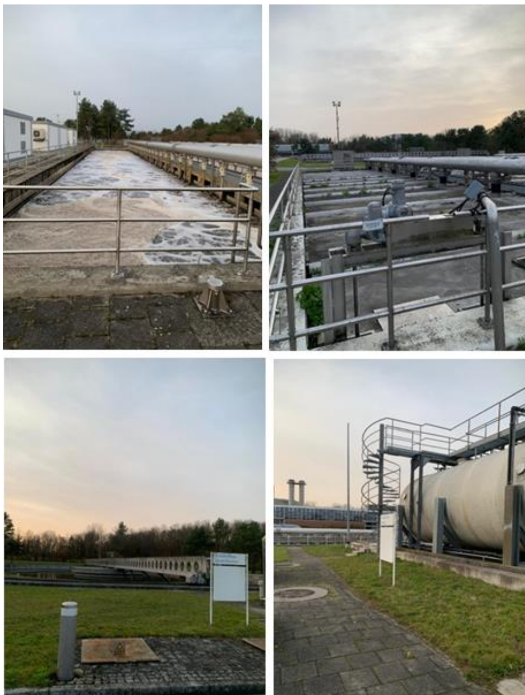
Figura 78. Tratamento biológico da Estação de Tratamento de Esgoto de Munique.
