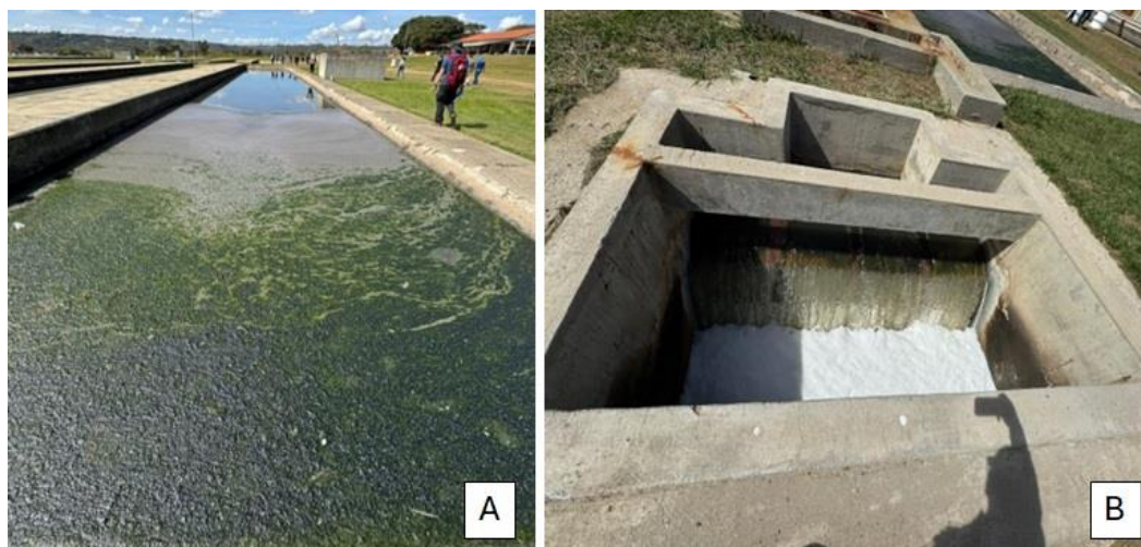
Figura 30. A) Lagoa anaeróbica; B) saída do efluente após o tratamento na lagoa anaeróbica, imediatamente antes de seguir para o tratamento aeróbico.
