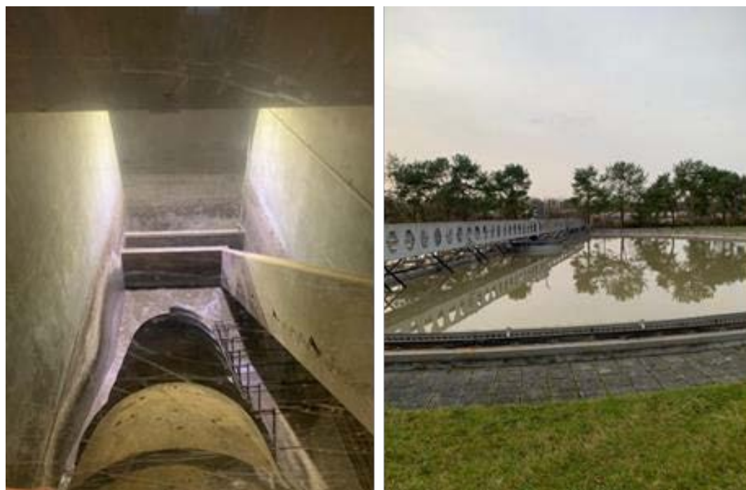
Figura 77. Elevatória do efluente e decantador primário da Estação de Tratamento de Esgoto de Munique.
