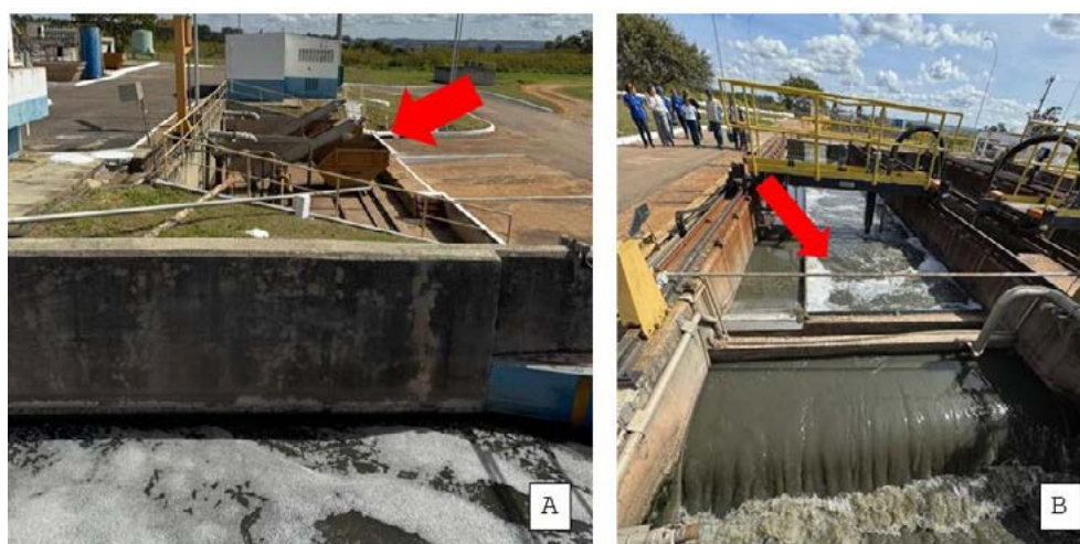
Figura 29. A) Caçambas coletoras dos sólidos removidos nas etapas de gradeamento grosso e de gradeamento fino. B) Tanque desanador.
