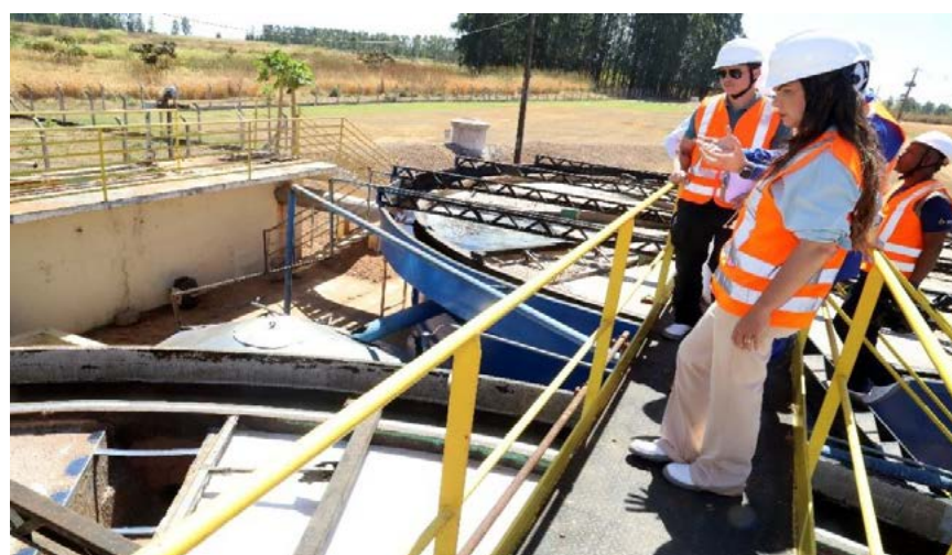
Figura 52. Equipamentos da etapa da flotação.
