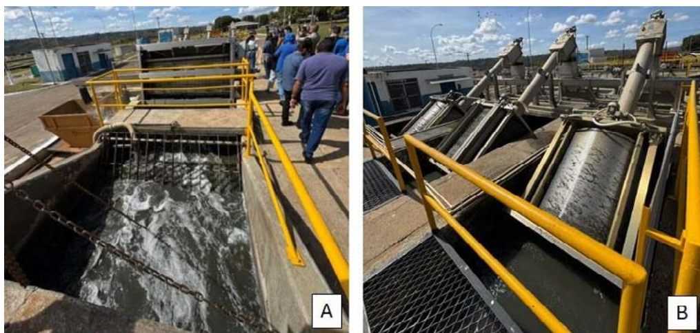
Figura 28. Etapa de gradeamento no sistema Melchior/Samambaia. A) Gradeamento grosso, que remove os sólidos maiores; B) gradeamento fino, que remove os sólidos menores.
