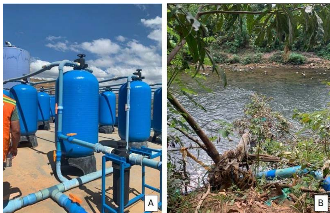
Figura 46. A) Filtros de zeólita; B) Emissário que faz o lançamento do chorume tratado no Rio Melchior.
