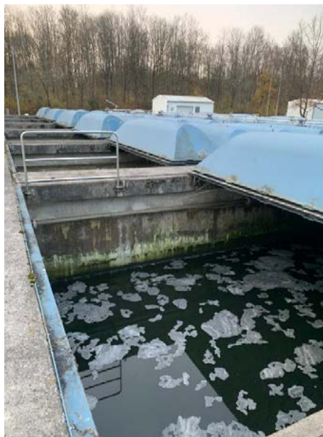
Figura 79. Filtros de areia da Estação de Tratamento de Esgoto de Munique.
