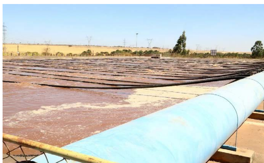
Figura 53. Tanque de lodos ativados, com aeração.
