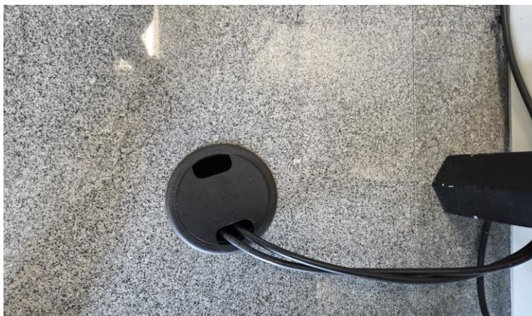
IMAGEM DA PASSAGEM DOS CABOS SAINDO DO PISO ELEVADO PARA ALIMENTAR AS TOMADAS INSTALADAS NA MESA.
