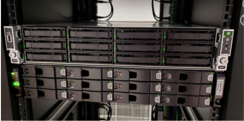
Imagem 2.4 - Equipamento instalado no rack
