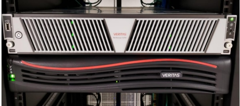
Imagem 2.5 - Equipamento instalado no rack
