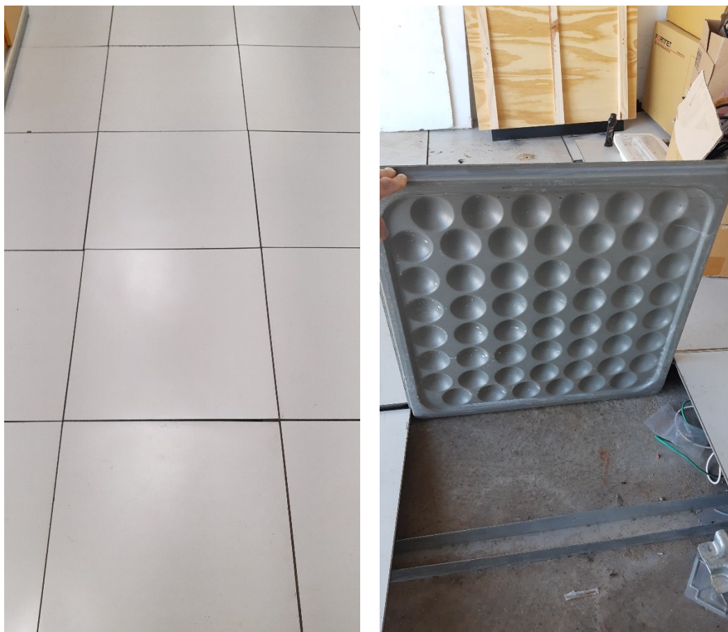
Figura 01 e 02 – Piso existente (CMI)
