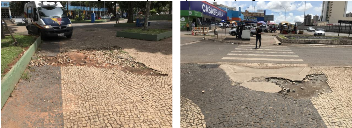
Figura 1: Estado precário do piso em pedra portuguesa
