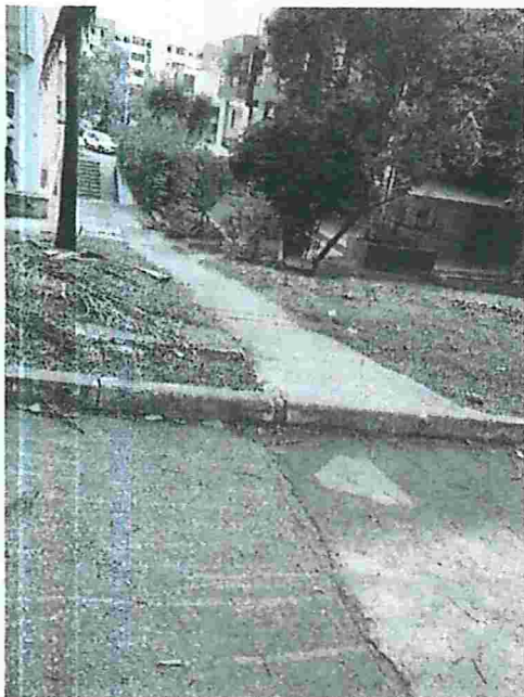
Local 13: Rampa não acessível
