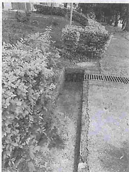
Local 3: Coletor para águas pluviais profundo sem grade de proteção
