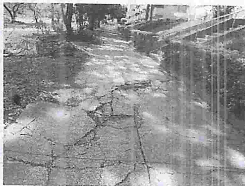
Local 2: Calçada quebrada
