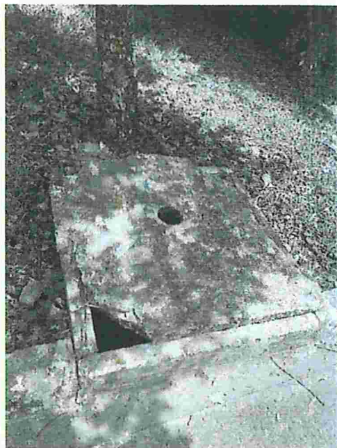
Local 14: Tampa de esgoto quebrada
