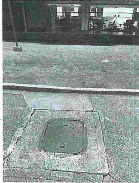
Local 6: Placa de cimento de boca de lobo solta
