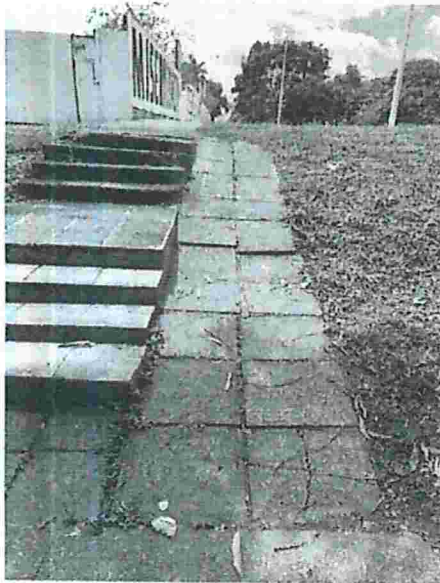
Local 7: Rampa íngreme, sem corrimão e estreita
