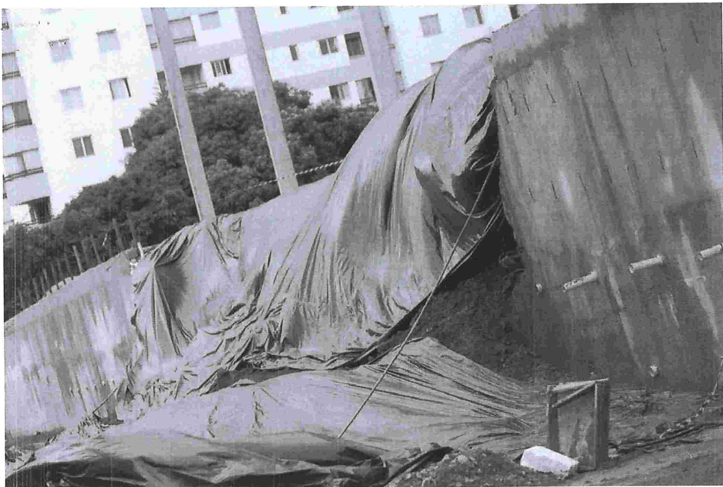
Muro de escola em construção entre as quadras 101 e 102 do Sudoeste desaba neste domingo (26/01/2020)
