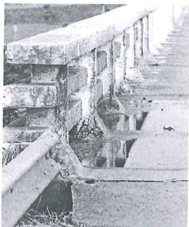
Ponte do Braguetto: vazamentos e rachaduras ameaçam estrutura
