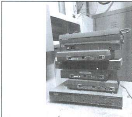
Figura 12 - Modems sem a fixação nos racks, causando risco de acidentes a todos os equipamentos. Foto tirada em 27/07/2016.
