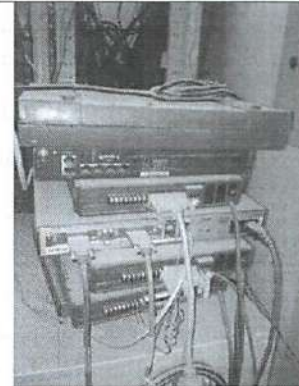
Figura 13 - Cabeamento e Modem sem identificação, o que causa risco de acidentes na manipulação além de dificultar a manutenção e intervenção em caso de incidentes. Foto tirada em 27/07/2016.
