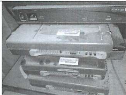
Figura 14 - Ausência de identificação dos circuitos de dados e acondicionamento incorreto dos equipamentos (roteador e modems), expondo os mesmos a acidentes e ação de poeira e umidade. Foto tirada em 27/07/2016.
