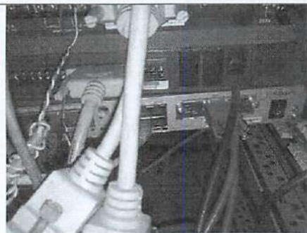
Figura 8 - Cabeamento sem identificação na entrada do roteador, o que causa risco de acidentes na manipulação além de dificultar manutenção e intervenção em caso de incidentes. Foto tirada em 02/06/2016.
