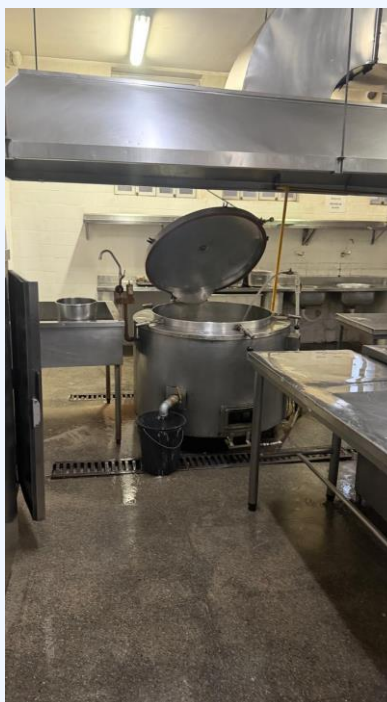
Fotografia 3 – Exaustor/coifa desligado na área de preparo de alimentos na cozinha geral do HMIB/SES-DF, Plano Piloto, DF
