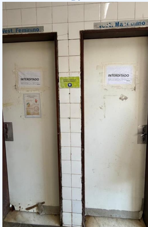
Fotografia 1 – Entrada para os banheiros interditados na cozinha geral do HMIB/SES-DF, Plano Piloto, DF
