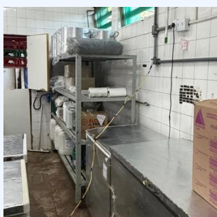
Fotografia 28 – Fiação elétrica exposta na área de estoque, cozinha geral do HMIB/SES-DF, Plano Piloto, DF
