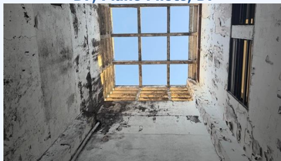
Fotografia 23 – Ausência de cobertura e forro na área de higienização de caixas, cozinha geral do HMIB/SES-DF, Plano Piloto, DF
