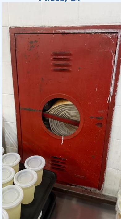
Fotografia 31 – Abrigo para mangueira de combate a incêndio bloqueado por carro de refeição, cozinha geral do HMIB/SES-DF, Plano Piloto, DF
