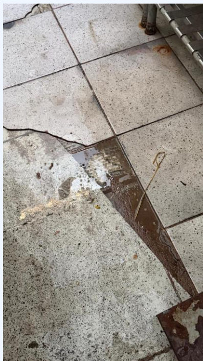
Fotografia 14 – Piso danificado e molhado na área de higienização de caixas, na cozinha geral do HMIB/SES-DF, Plano Piloto, DF
