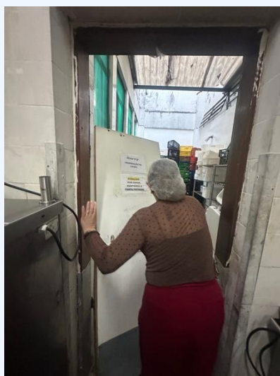
Fotografia 17 – Porta solta na entrada da área de higienização de caixas, cozinha geral do HMIB/SES-DF, Plano Piloto, DF
