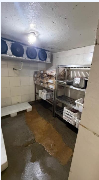
Fotografia 12 – Parte interna de uma das câmaras frias, com piso molhado, exaustores danificados e ausência de termostato e termômetro, na cozinha geral do HMIB/SES-DF, Plano Piloto, DF
