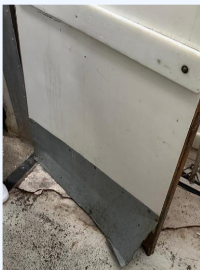
Fotografia 18 – Placa de proteção metálica solta na entrada da área de higienização de caixas, cozinha geral do HMIB/SES-DF, Plano Piloto, DF
