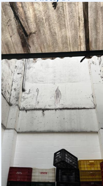
Fotografia 15 – Presença de mofo nas paredes e cobertura, na área de higienização de caixas, cozinha geral do HMIB/SES-DF, Plano Piloto, DF
