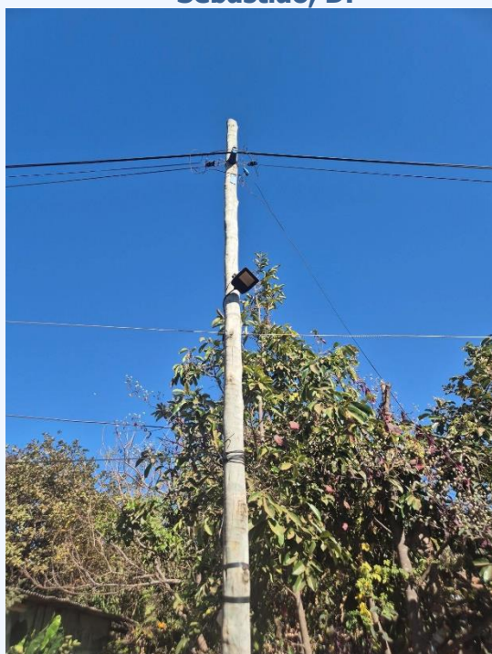
Fotografia 5 – Poste de iluminação pública instalado por moradores, Assentamento Tiradentes, RA São Sebastião, DF
