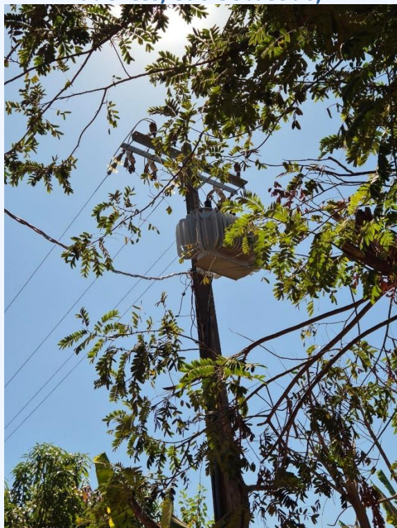
Fotografia 3 – Ligação irregular de energia elétrica no Assentamento Tiradentes, São Sebastião, DF
