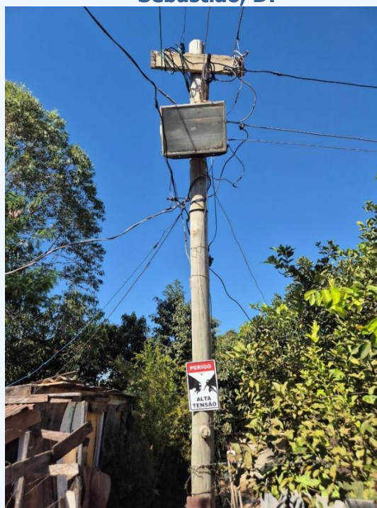
Fotografia 6 – Poste de iluminação pública instalado por moradores, Assentamento Tiradentes, RA São Sebastião, DF
