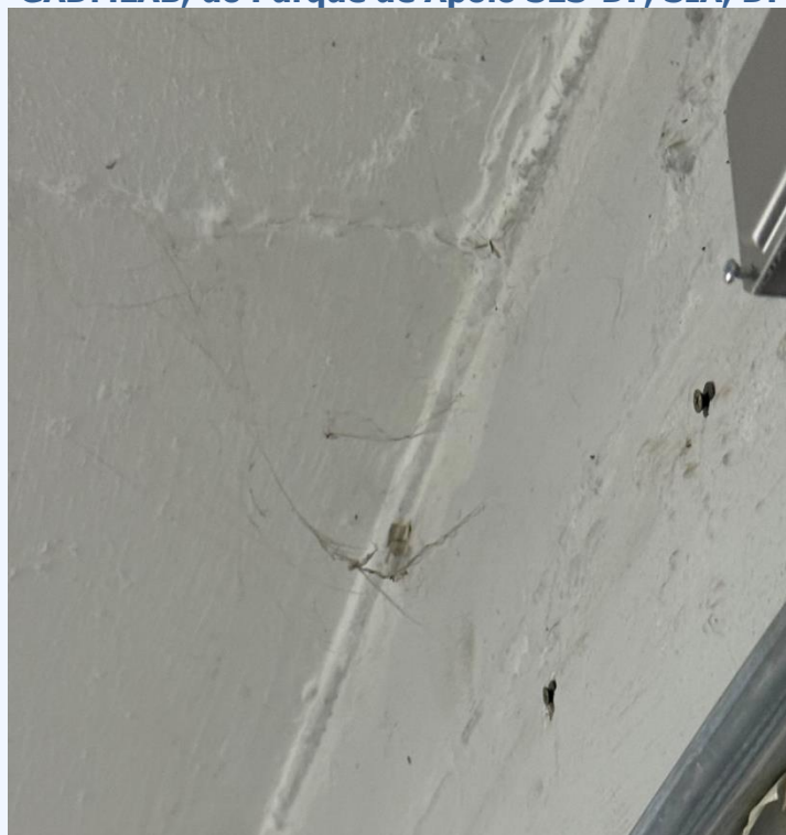
Fotografia 9 – Acúmulo de sujeira na área de câmaras refrigeradas no GADMLAB, do Parque de Apoio SES-DF, SIA, DF
