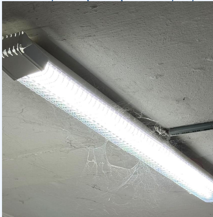
Fotografia 8 – Acúmulo de sujeira na área de câmaras refrigeradas no GADMLAB, do Parque de Apoio SES-DF, SIA, DF
