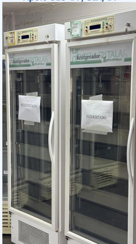
Fotografia 7 – Câmaras refrigeradas inoperantes em decorrência de falhas técnicas, no GADMLAB, do Parque de Apoio SES-DF, SIA, DF
