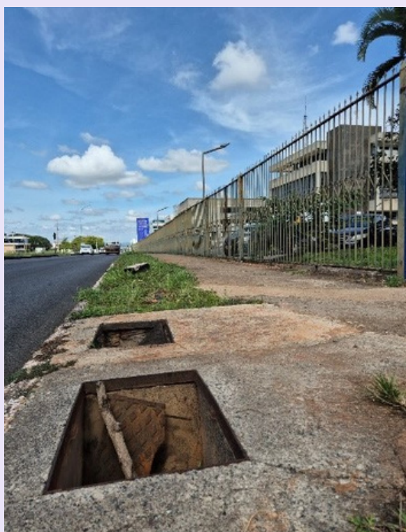
Fotografia 6 - Calçada com tampas de poços de inspeção quebradas
