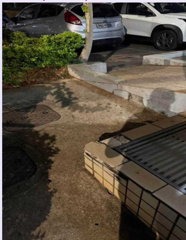
Fotografia 5 - Calçada interrompida por rampa inadequada à norma
