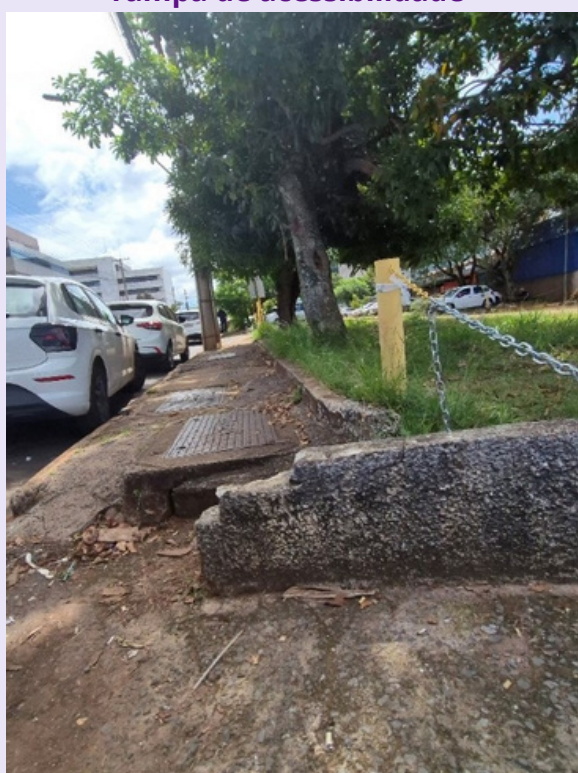
Fotografia 8 – Calçada com desnível, sem rampa de acessibilidade
