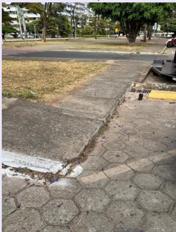
Fotografia 4 - Calçada com rampa de acessibilidade fora do padrão normativo
