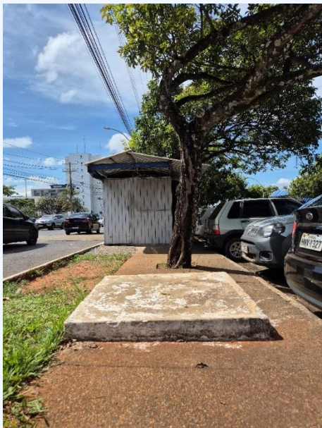
Fotografia 8 – Calçada com base de concreto em área de faixa livre nas proximidades da CLDF – RA Sudoeste
