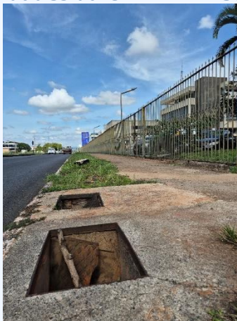
Fotografia 13 – Calçada com tampas de poços de inspeção quebradas nas proximidades da CLDF – RA Sudoeste
