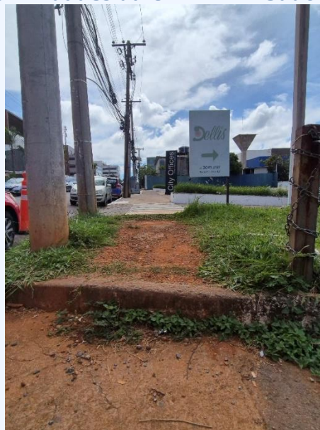
Fotografia 15 – Calçada com desnível, sem rampa de acessibilidade nas proximidades da CLDF – RA Sudoeste
