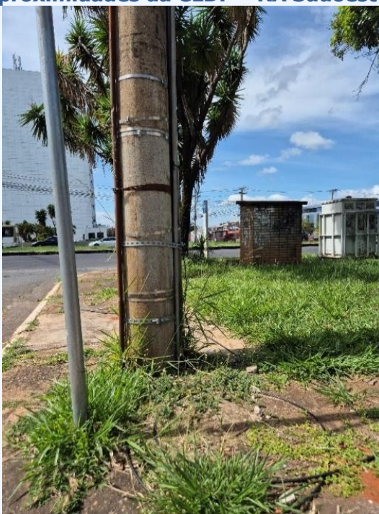
Fotografia 10 – Calçada com poste de energia elétrica em faixa livre nas proximidades da CLDF – RA Sudoeste
