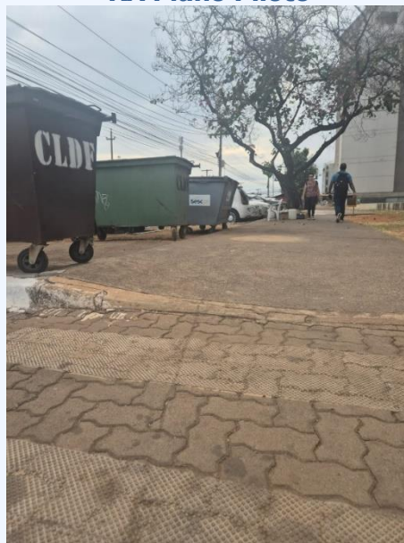
Fotografia 20 – Calçada da CLDF com desnível sem rampa de acessibilidade, RA Plano Piloto
