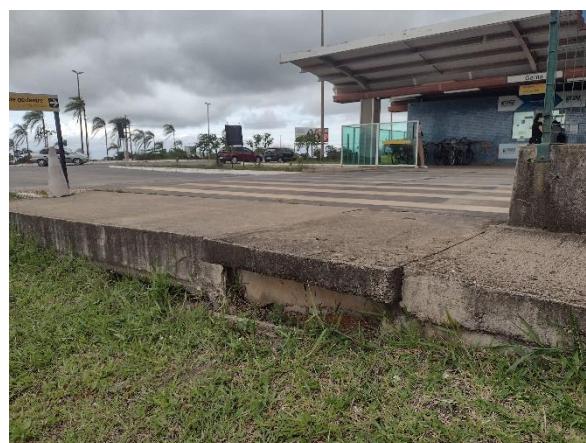
Figura 18 – Desnível sem proteção guarda corpo Fonte: Autoria própria
