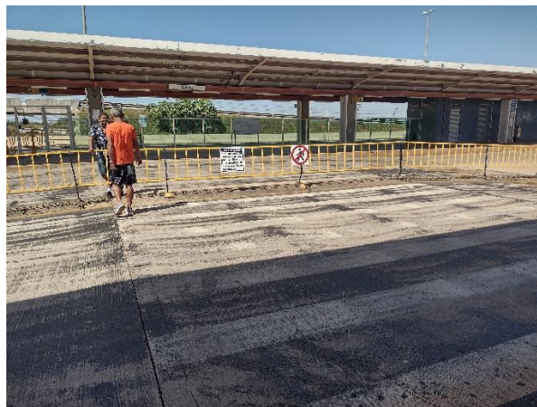
Figura 22 – Travessia elevada bloqueada Fonte: Autoria própria
