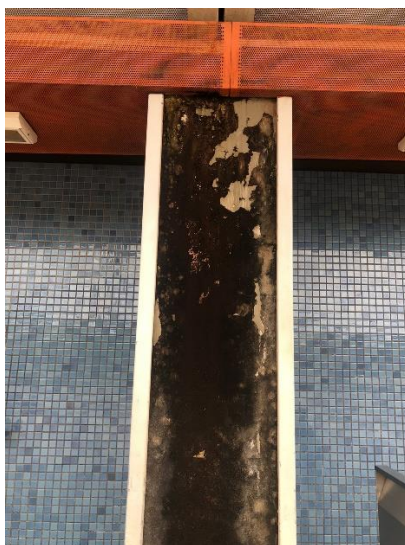
Figura 30 – Pilar com manchas características de mofo
